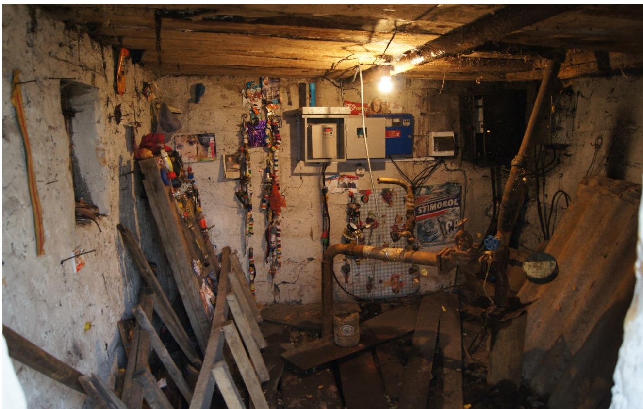
Рисунок 2.2 – Павильон рабочей скважины системы централизованного водоснабжения с. Новотроицк
