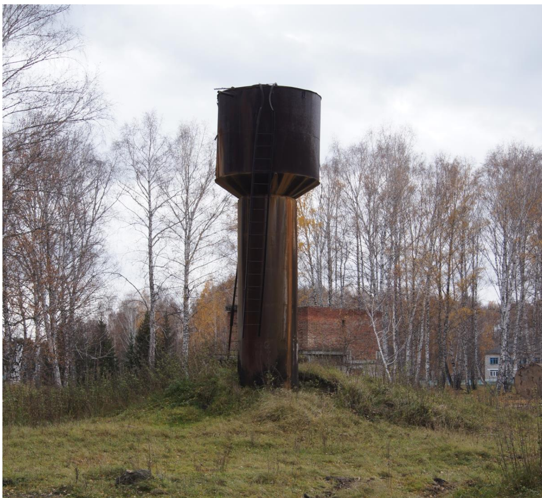
Рисунок 2.5 – Водонапорная башня вблизи рабочей скважины системы централизованного водоснабжения с. Новотроицк
